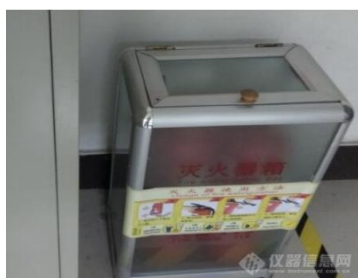
图 1-12 存放危险化学品的旁边要有消防器材
